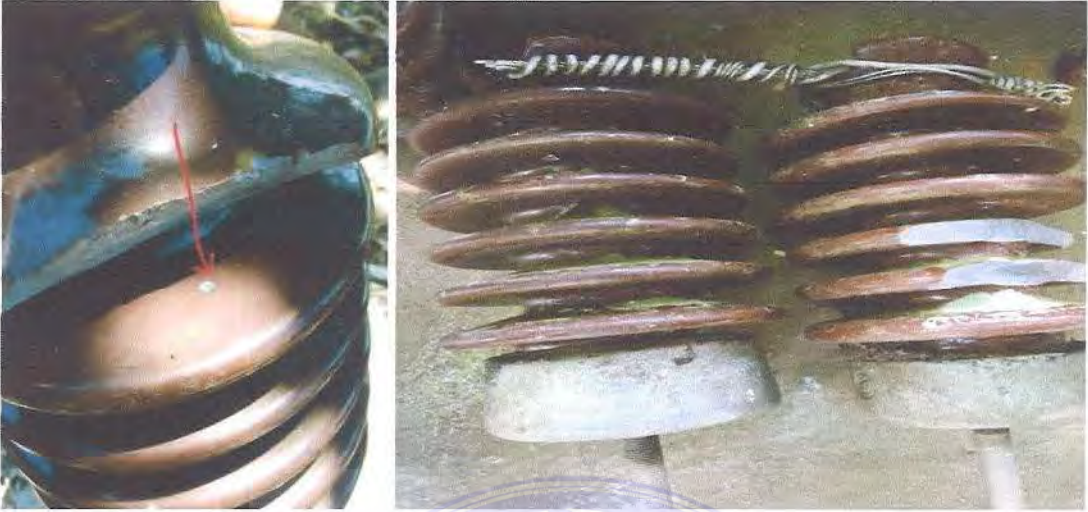
Gambar 8.1 Komponen isolator JTM yang rusak
