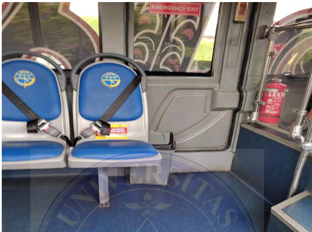
Gambar Fasilitas Alat Pemadam Api Ringan (Fire Extinguisher)
