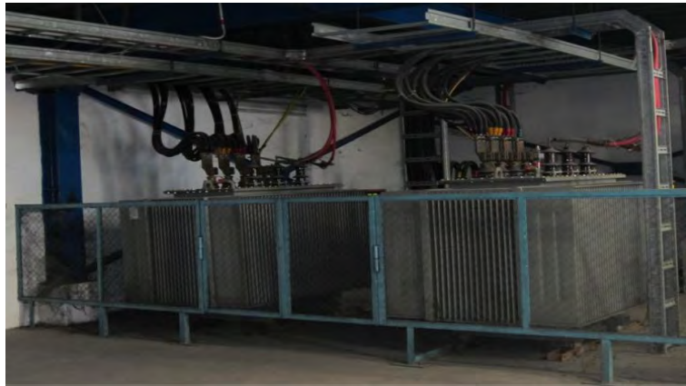
Gambar 3. 13 Trafo 5 Dan Trafo 7
