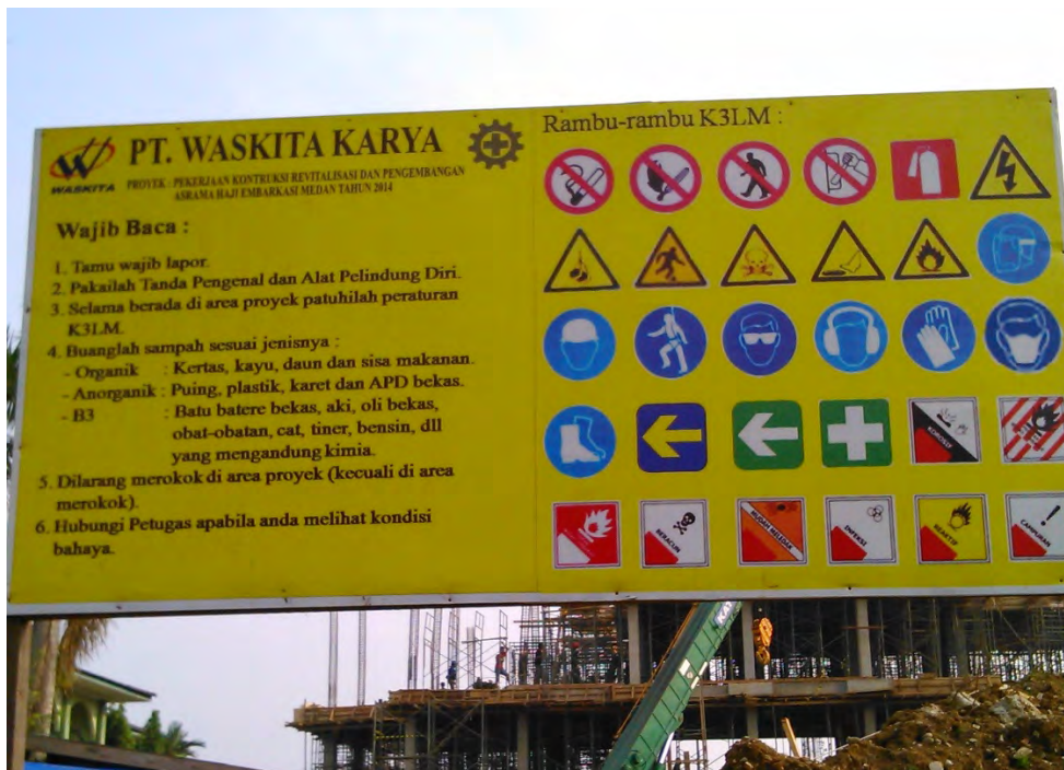
Gambar 2. Rambu-rambu K3LM dalam Proyek Pembangunan Gedung Asrama Haji Medan
