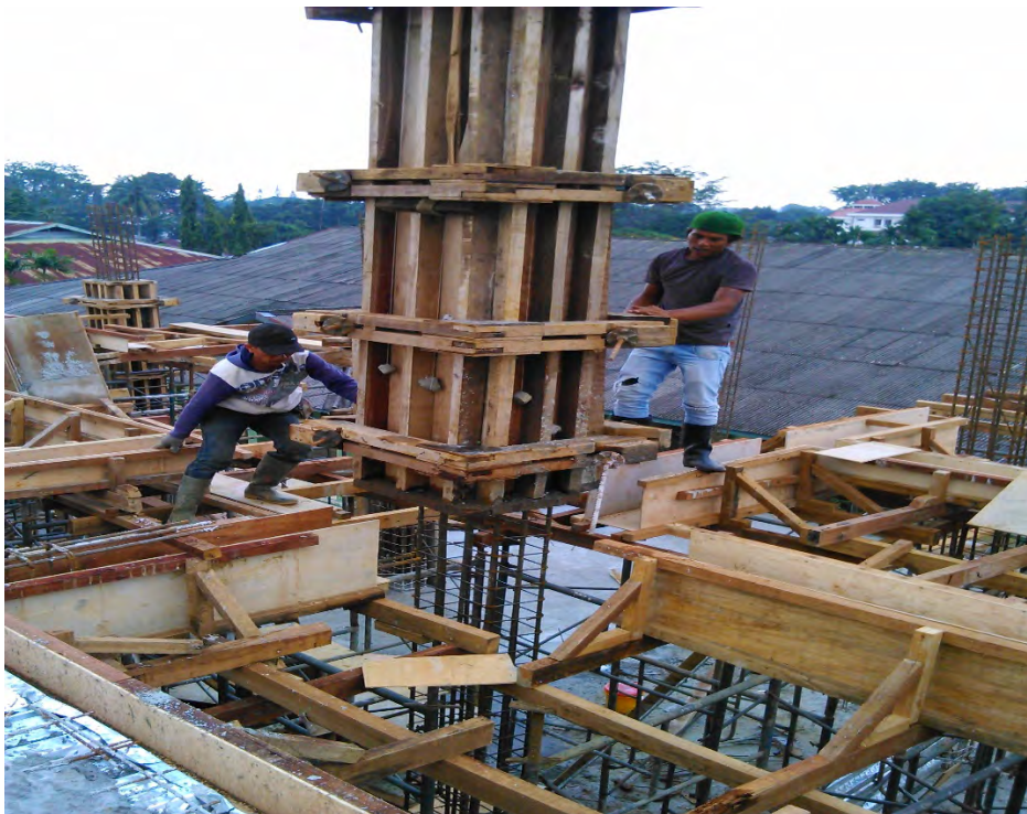
Gambar 10. Proses Pembukaan Bakisting Kolom dengan alat bantu Tower Crane Lokasi : Jalan A.H. Nasution Kec.Medan , Medan
