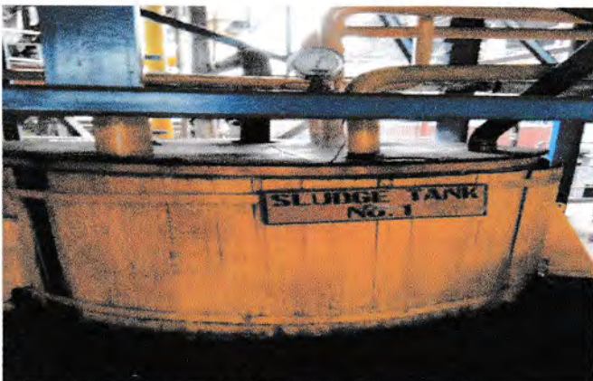
Gambar: 4.11. Sludge Tank
